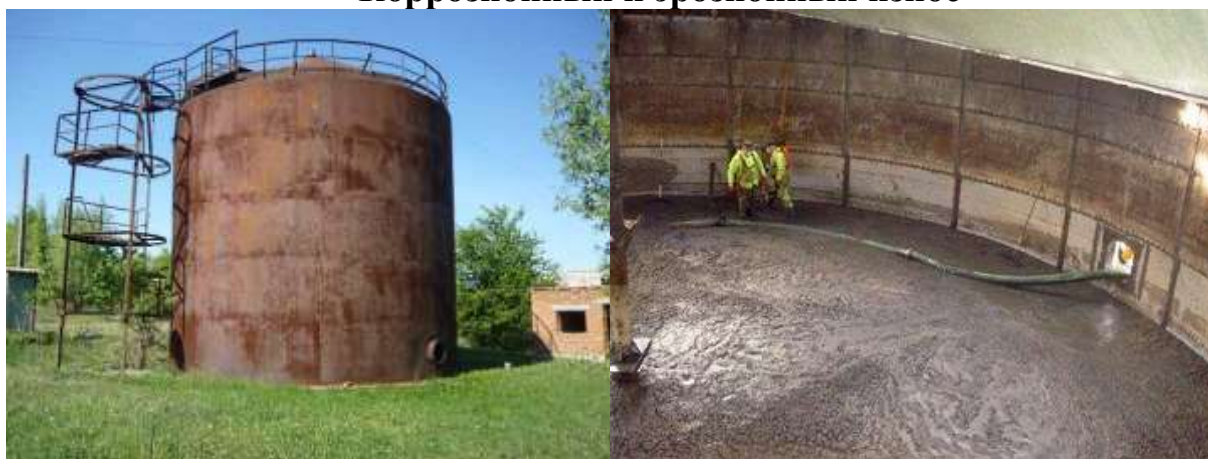
Рисунок 1.1 – Коррозионный и эрозионный износ
